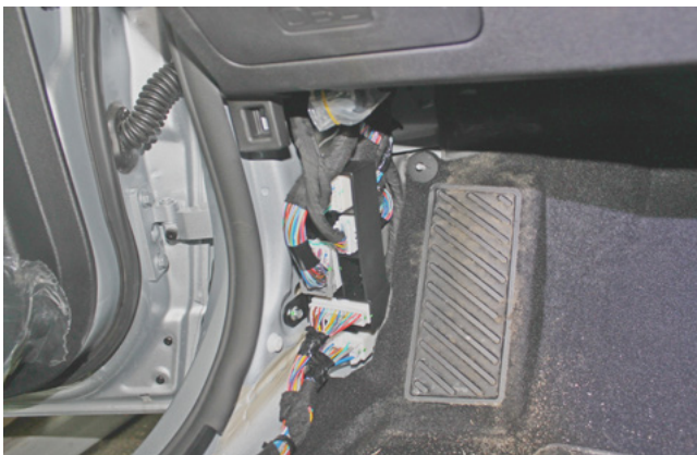
Фото 1.9. Накладка левой кик-панели снята
